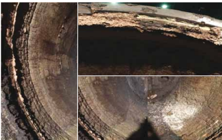
Рис. 3. Футеровка сталеразливочного ковша с нанесенным шоткрет-слоем после эксплуатации (124 плавки)
