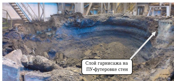
Рис. 7. Состояние футеровки ДСП после окончания кампании (610 плавов)
