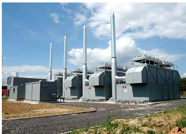
Рис. 7. Один из энергоблоков мощностью 12 МВт
