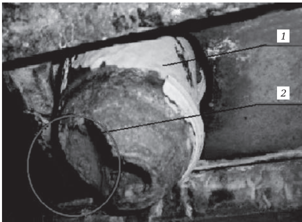
Рис. 2. Эрозия стакана-коллектора (1); 2 — зона эрозии
