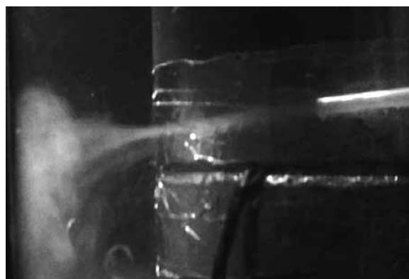
Рис. 5. Работа вытяжного вентилятора
