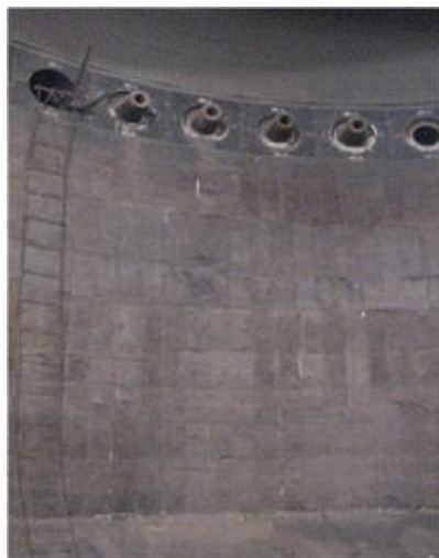
Рис. 1. Искусственный гарнисаж футеровки горна ДП объемом 5500 м 3 , выполненный из бетона марки Metpump
