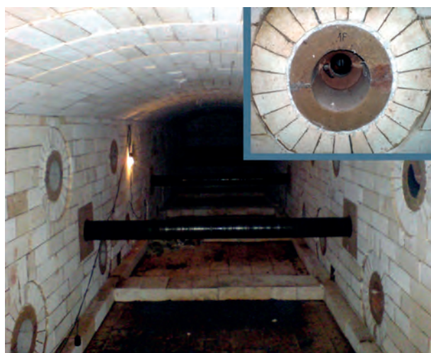
Рис. 5. НЛМК, печь непрерывного горячего цинкования АНГЦ-3 после двух лет работы, 2011 г. (проект компании «Теплохиммонтаж»)
