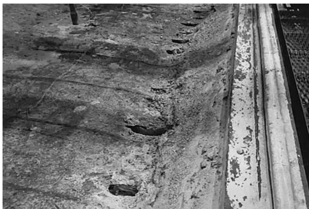
Рис. 2. Полости на поверхности подины на входной стороне
