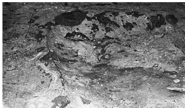
Рис. 1. Поверхность подины электролизера ОА-300М1 после отключения
