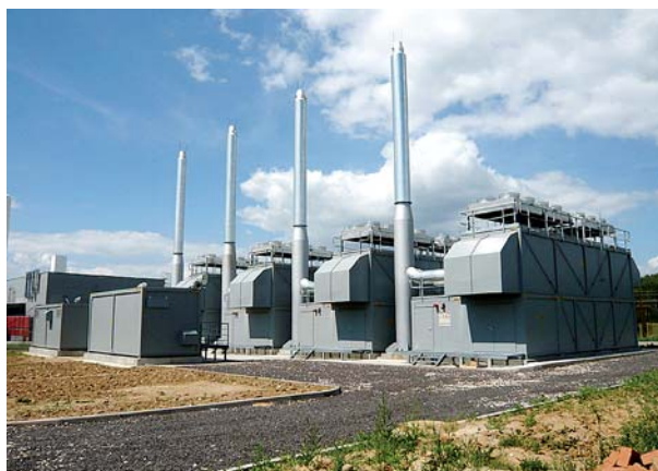
Рис. 7. Один из энергоблоков мощностью 12 МВт
