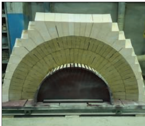
Рис. 19. Штыцер горячего дутья воздушонагревателя доменной печи, собранный из комплекта кварцевых керамобетонных блоков
