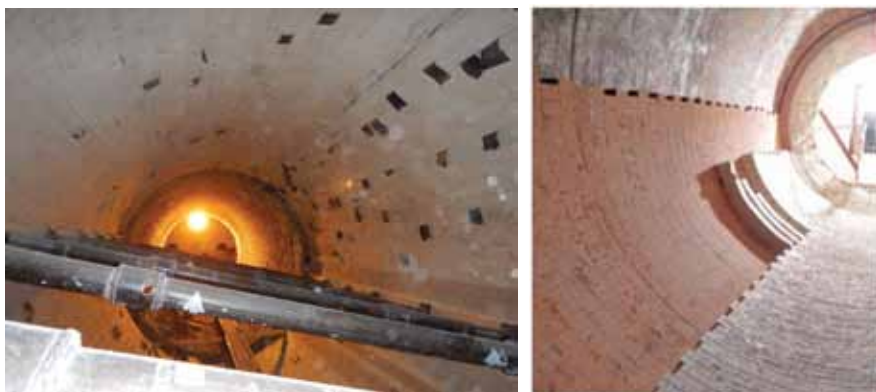
Рис. 6. Футеровка вращающейся печи № 6 для обжига извести ИДЦ
