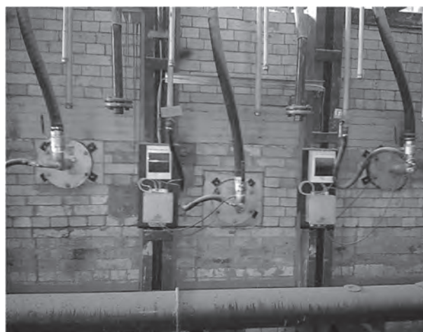
Рис. 4. Расположение горелок ГНБ-80 и блоков управления ТК1301.03 на боковой стене печи
