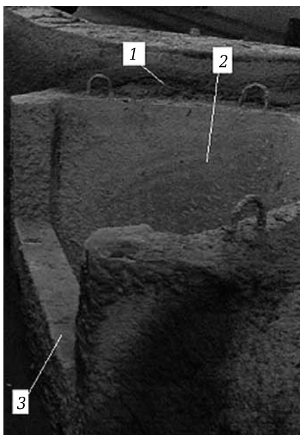
Рис. 3. Приемная камера ПК, оснащенная защитой ее боковой поверхности: 1 — приемная камера; 2 — защита боковой поверхности ковша; 3 — порог на границе приемной и разливочной камер
